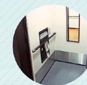
エレベーター
