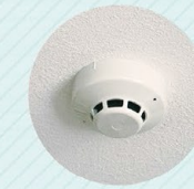
火災報知設備
