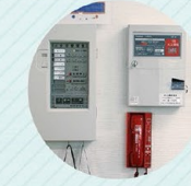
火災通報装置
